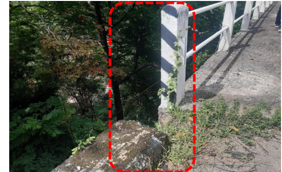
คอสสะพานมีความชำรุด
