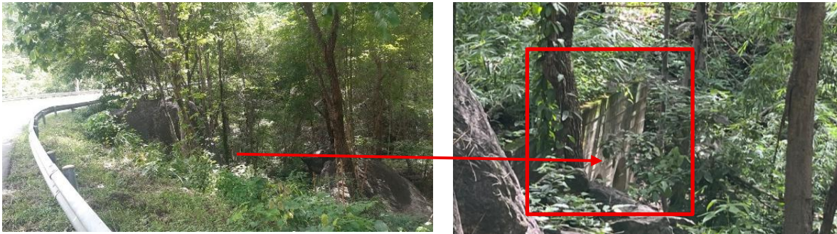
รูปที่ 5-8 สภาพปัจจุบันของระบบระบายน้ำตามขวาง
