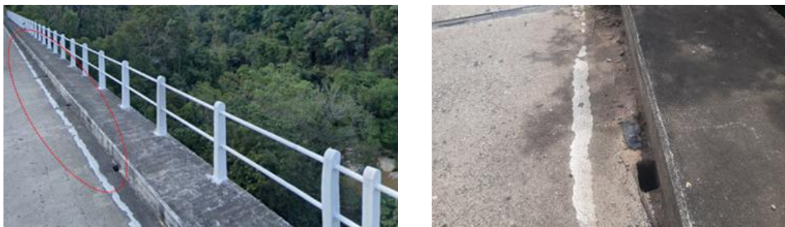
รูปที่ 5-10 สภาพปัจจุบันของระบบระบายน้ำบนสะพาน
