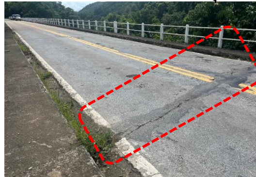
รอยต่อสะพานมีความชำรุด
