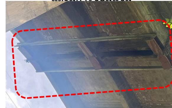
โครงสร้างมีความชำรุด และมีการซ่อมแซม
